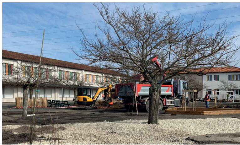
Le bitume cassé de la cour d'école Joliot Curie en février 2022
